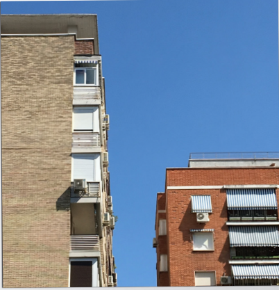
Grietas y siluetas
